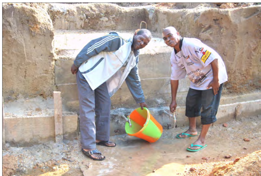
Source , Momita à Ouesso (situation après)
